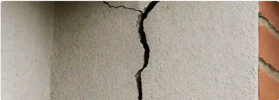
Структурні дефекти стін
