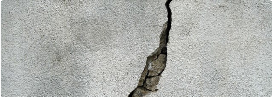
Тріщини в бетонних конструкціях
